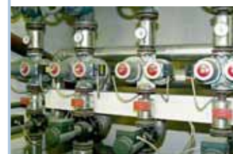
Hackschnitzelheizungen sind technisch ausgereift und bieten denselben Komfort wie Ölheizungen.
